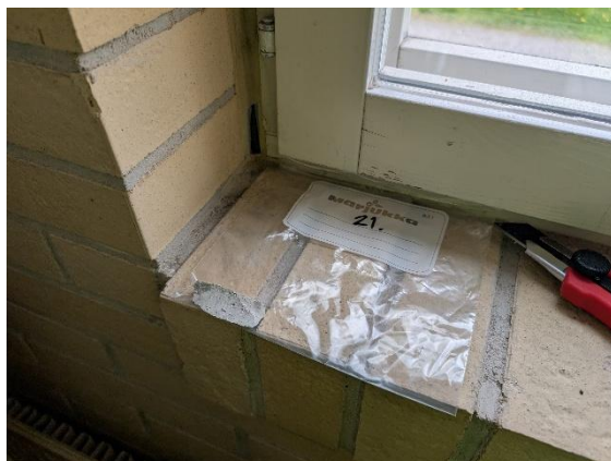
Ikkunoiden tiivistyskiteissä on raskasmetalleja sekä SCCP-yhdisteitä.
