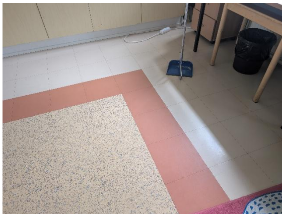
Asbestia sisältäviä vinyylilaatoituksia kerhohuoneessa
