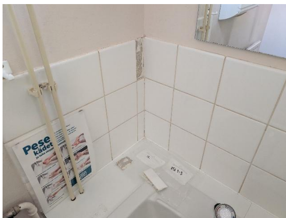
Kerhuhuonetta vastapäätä olevissa vessoissa on laattojen kiinnityslaastissa asbestia
